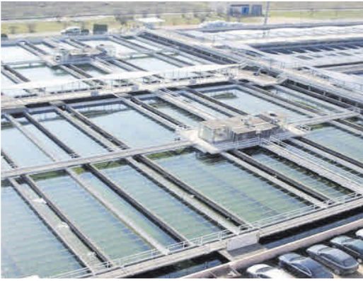
La planta potabilizadora del río Ter.
